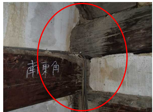
写真3 雨漏り、腐朽箇所の例
